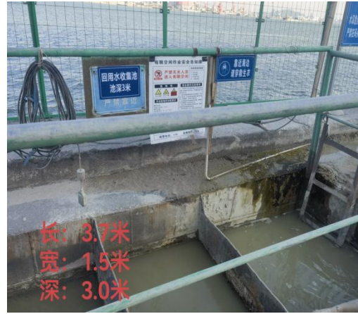
图 2-6 回用水收集池
